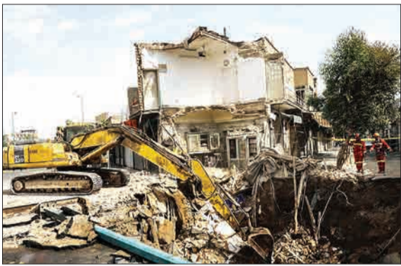
صبح دیروز ضلع شمالی میدان مطهری شهر قم در اثر انفجار گاز دچار نشست شد و تعدادی از مغازه‌ها فروریختند.
