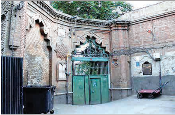
خانه «اتحادیه» یا همان خانه «ای‌جان تاپیلون» در تهران که متعلق به دوران قاجار است و دوسال پیش گفته شده بود در قالب موزه افتتاح خواهد شد. این روزها شاهد تحولاتی است. درهای خانه اتحادیه‌تونوار شده‌اند و بنظر می‌رسد همه چیز آماده است. (ایستا)
